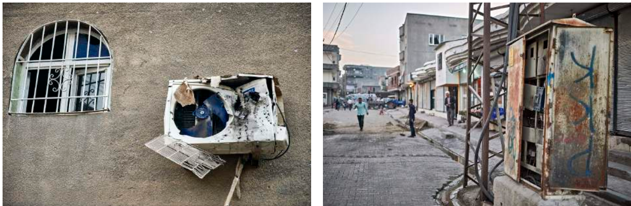
Augenschein im Nur-Quartier: zerschossenes Aggregat und ein unbrauchbar gemachter Stromtrafo
